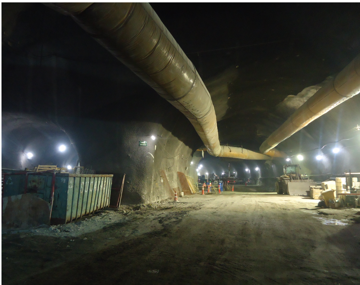
Figura 23. Tubos do Sistema de Insuflação e Ventilação no interior do túnel. Fonte: Acervo da empresa.
