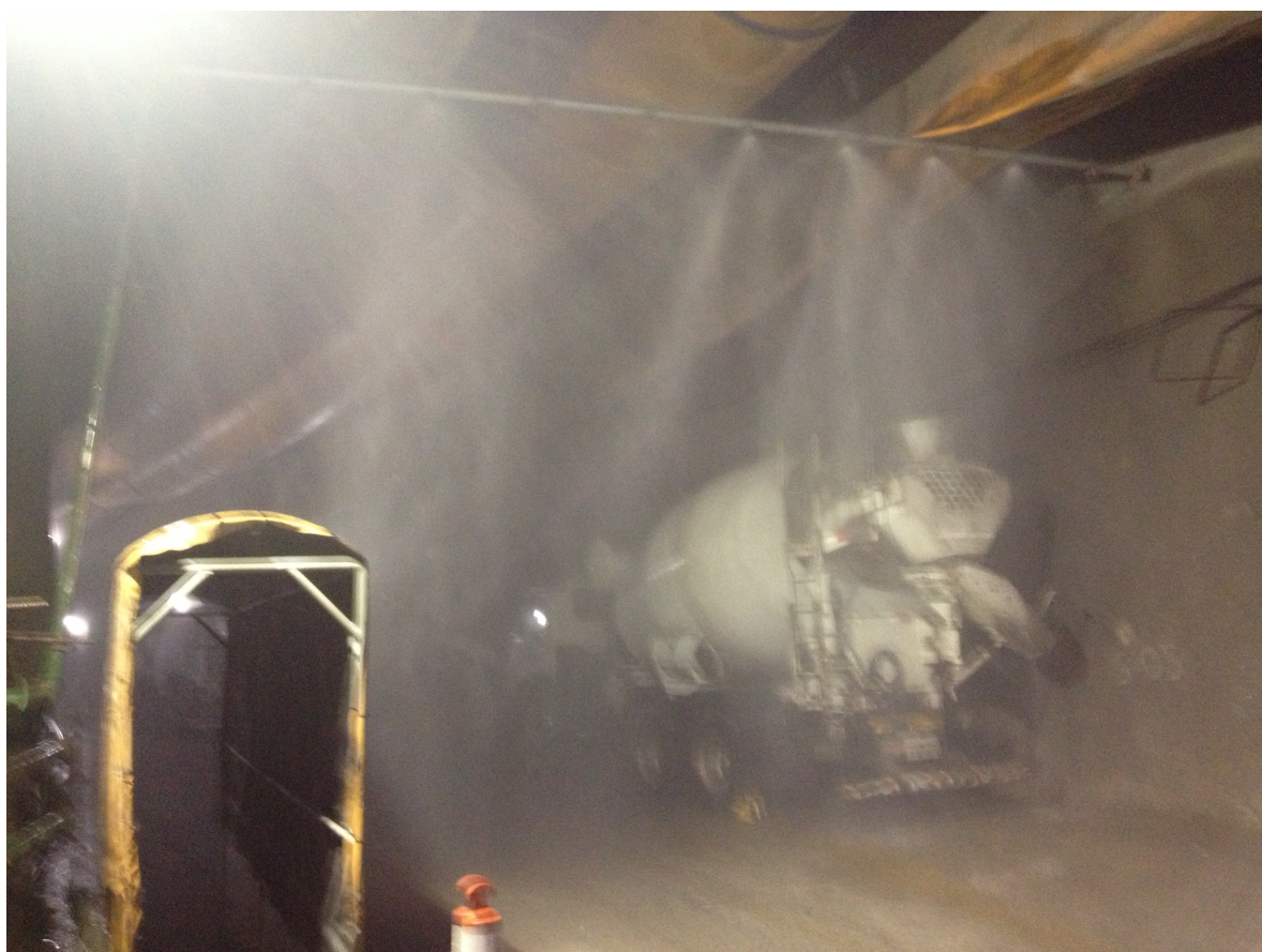
Figura 32. Sistema de aspersão. Fonte: Acervo da empresa.
